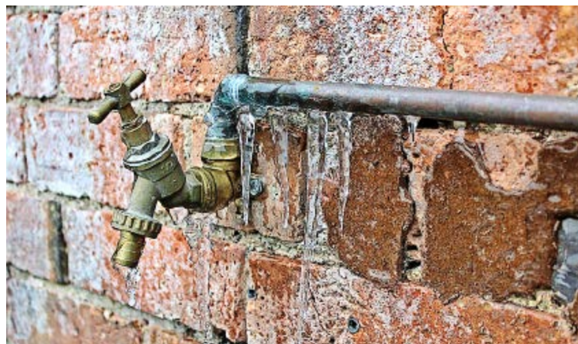
Schäden durch auslaufendes Wasser. Bild: Pixabay
