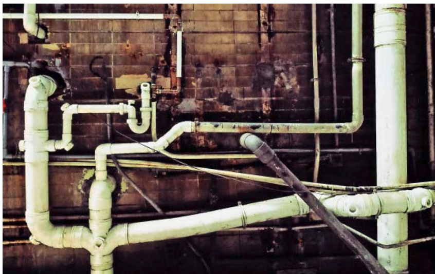
Wasserleitungen sind nicht in jedem Fall über die Gebäudeversicherung des Kanton Zürich (GVZ) versichert. Bild: Pixabay
