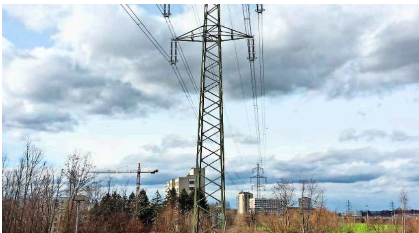
Masten und Leitungen im Land: Klarheit über anstehende Entschädigungen schafft das Grundbuch. Bild: Philipp Keller
