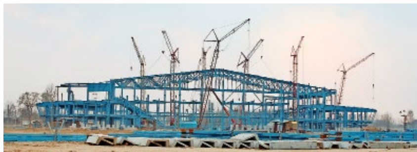
Bauvorhaben, die aufgrund ihrer Grosse oder Nutzung potenziell erheblich umweltbelastend sind, gelten als UVP-pflichtige Anlagen. Bild: Adobe Stock
