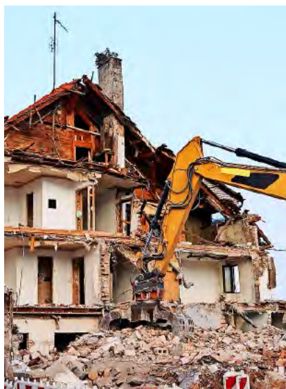
Als letzte Massnahme kann es auch zu einem angeordneten Rückbau des Gebäudes kommen. Bild: Adobe Stock
