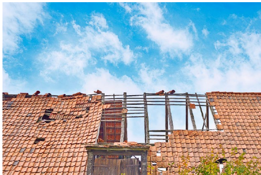
Versichert sind Gebäudeschäden, die z.B. durch Feuer oder Sturmwind entstanden sind. Bild: Adobe Stock
