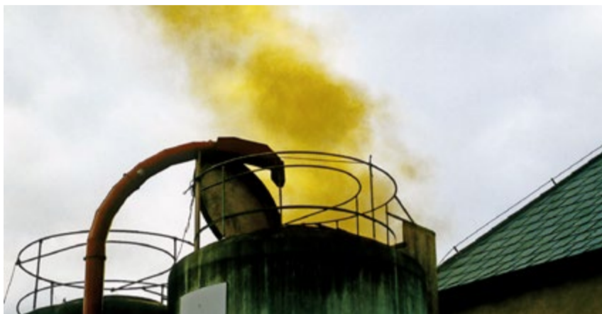
Hier wurde vor einigen Minuten der Silo zum Nachfüllen geöffnet. Die austretenden Nitrosegase schaffen im Bereich der Silos eine tödliche Gefahr. Bild: zVg
