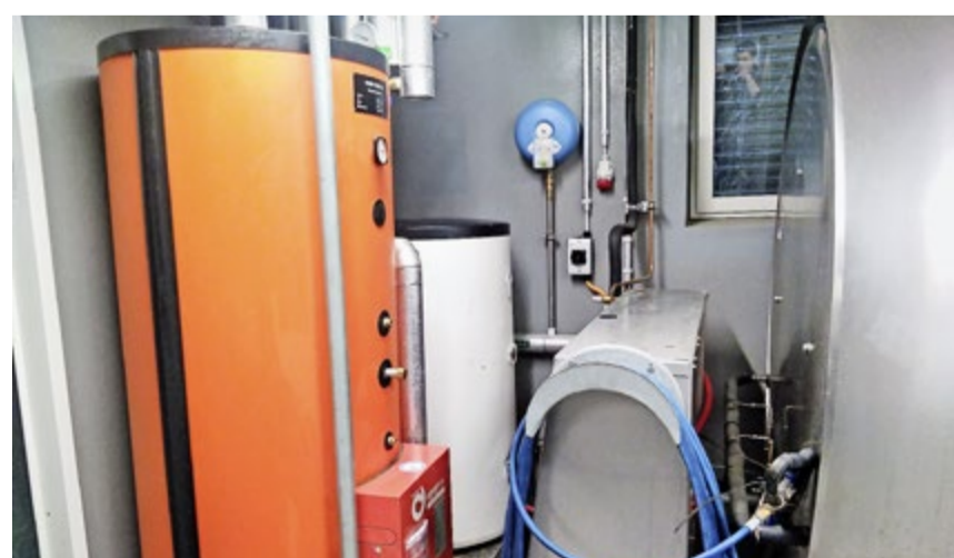
Die Wärmerückgewinnung bei der Milchgewinnung kann dazu beitragen, die Stromkosten zu reduzieren. Bild: Strickhof
